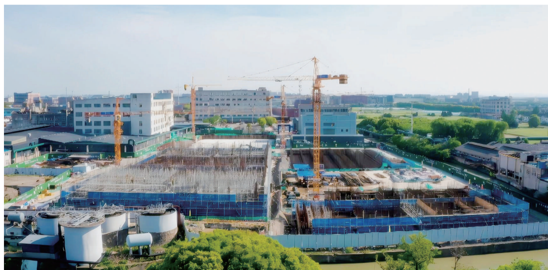
本报讯 近日,由江苏交建公司承建的江苏无锡长泾第一污水处理厂(一期)工程首个子单位工程土建顺利完工。项目建成后,将实现印染废水“分类收集、分质处理”,有力推动当地印染产业升级,极大改变人居环境。(刘壮文/供图)
